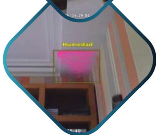
Fotografía diagnosticam: Detección de humedades clara y concisa
